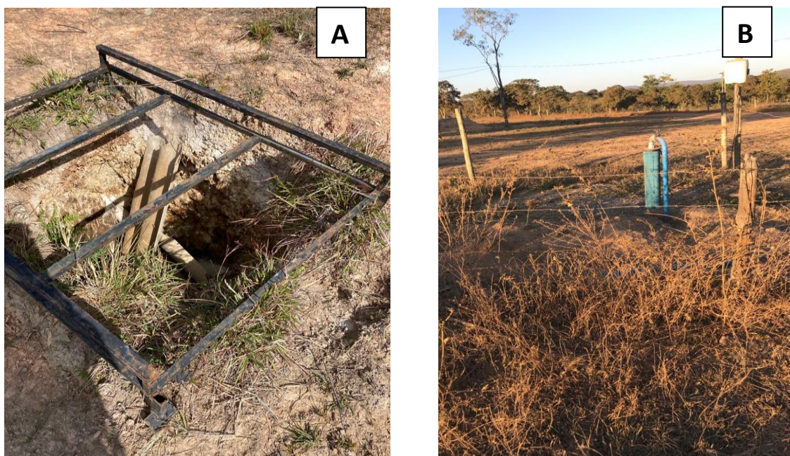
Figura 6.4 - Instalação de poços fora na normativa da ABNT. A: Possível cisterna sem a isolamento e vedação sanitária adequada. B: Poço tabular sem a proteção sanitária adequada.
