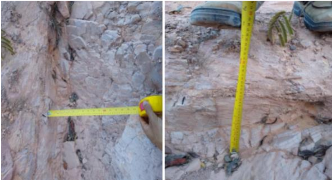
Figura 12 - Sulco erosivo em uma estrada da região. Fonte: Acervo pessoal
