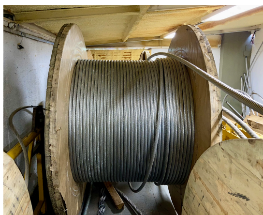
(b) Bobina do cabo condutor.
