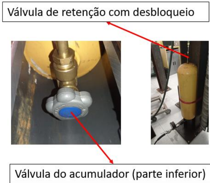
Figura 92. Válvulas do acumulador hidráulico. (Fonte: autoria própria)
