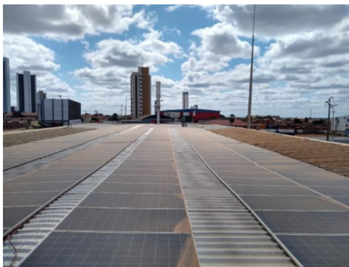
Figura 8 – Módulo com acúmulo de sujeira. Fonte: (MOURA; ANDRADE; SOUZA, 2021)
