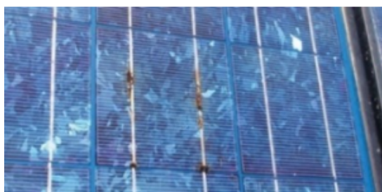
Figura 11 – Módulo sob efeito da corrosão. Fonte: (SILVA, 2018)
