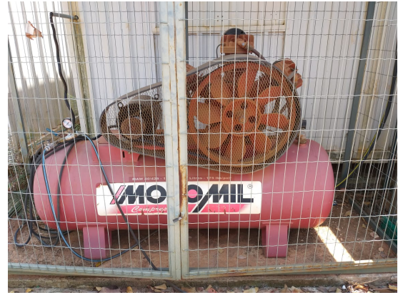
Figura 18 – Compressor de ar
