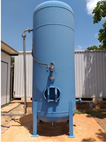
Figura 17 – Tanque de ar
