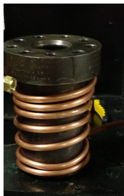
Figura 51 – Sistema de aquecimento do gás de entrada do reator.
