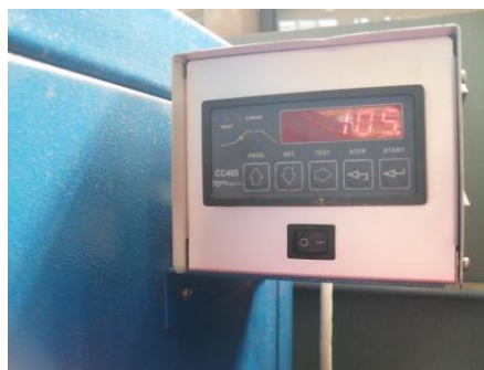
Figura 5.7 Controlador de operação do forno.
