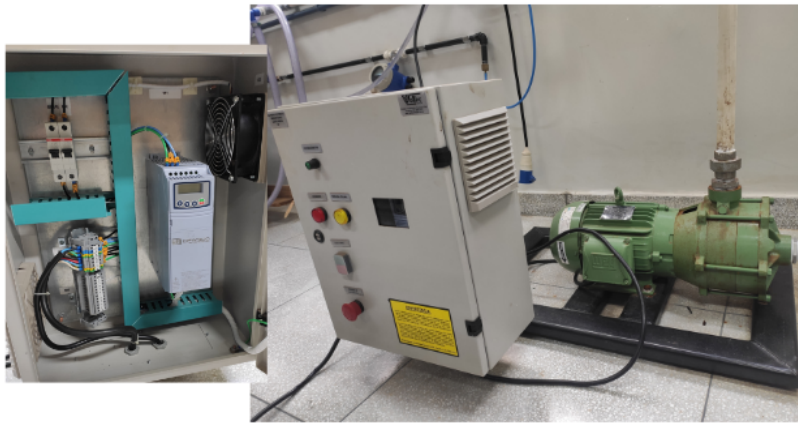
Figura 22 – Moto Bomba e Caixa Elétrica
