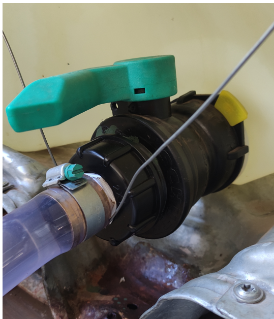
Figura 29 – Conector entre o Tanque e tubulação
