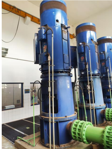
Figura 4.6 – Conjunto motor-bomba da EAT.MDA.001
