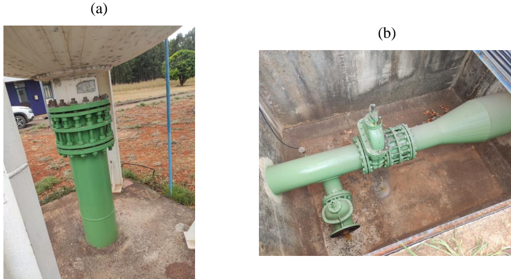
Figura 4.13 – Ligação do RHO. (a): conexão de entrada; (b): ramal de ligação com a redução
