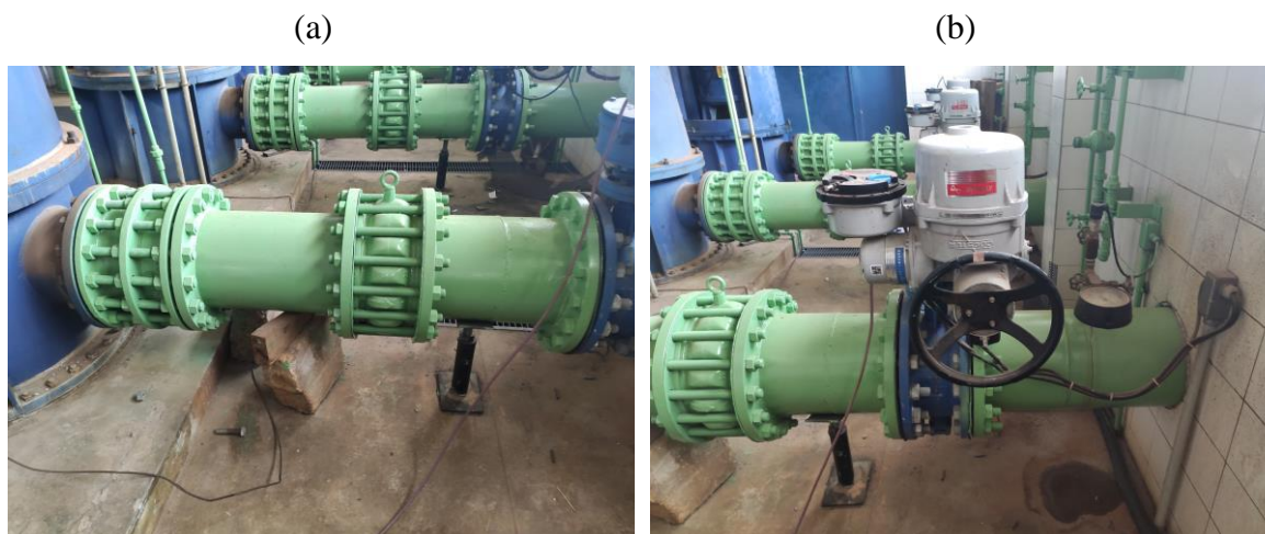
Figura 4.9 – Barrilete de recalque. (a): válvula de retenção; (b): válvula de bloqueio
