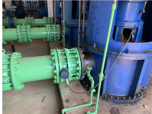
Ponto B – Recalque (montante da VR)
