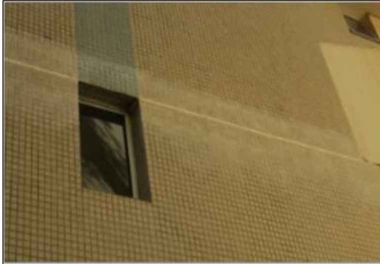
Figura 2.7 – Eflorescência na região de transição de pavimentos. Fonte: Autor.
