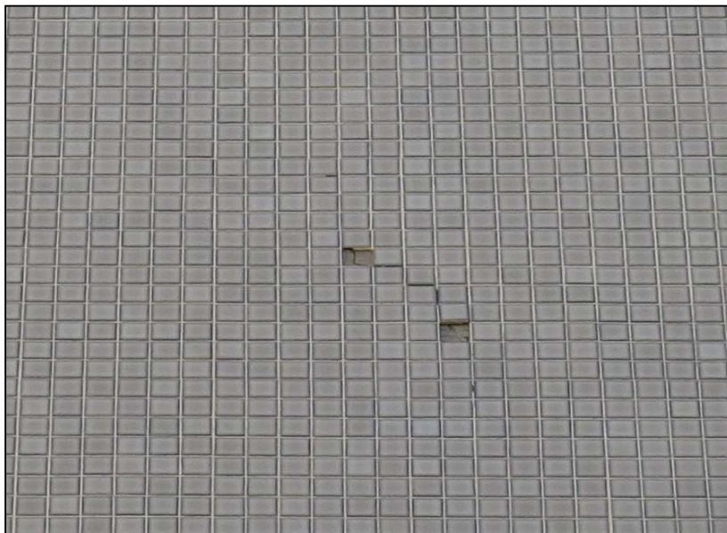
Figura 2.3 – Fissura evoluindo para descolamento cerâmico. Fonte: Autor.
