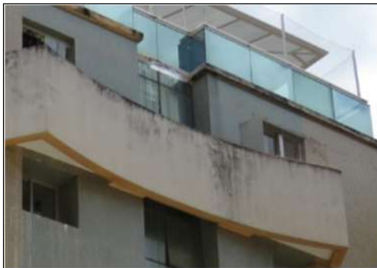
Figura 2.9 – Manchas de umidade em sacada. Fonte: Autor.
