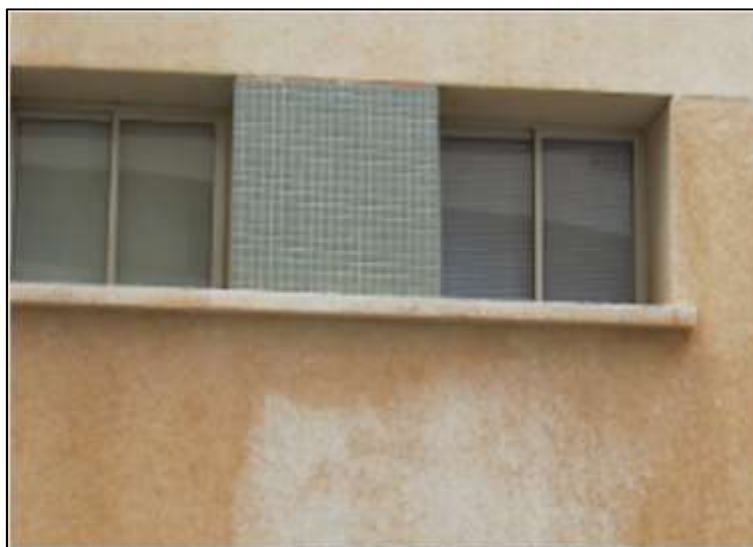
Figura 2.11 – Manchas de sujeira. Fonte: Autor.
