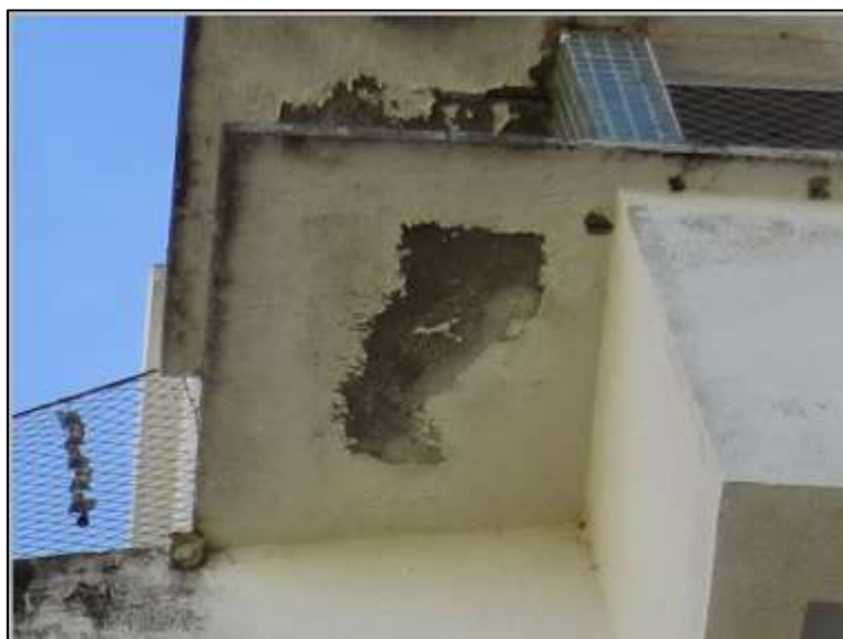
Figura 2.4 – Descolamento de revestimento em argamassa. Fonte: Autor.
