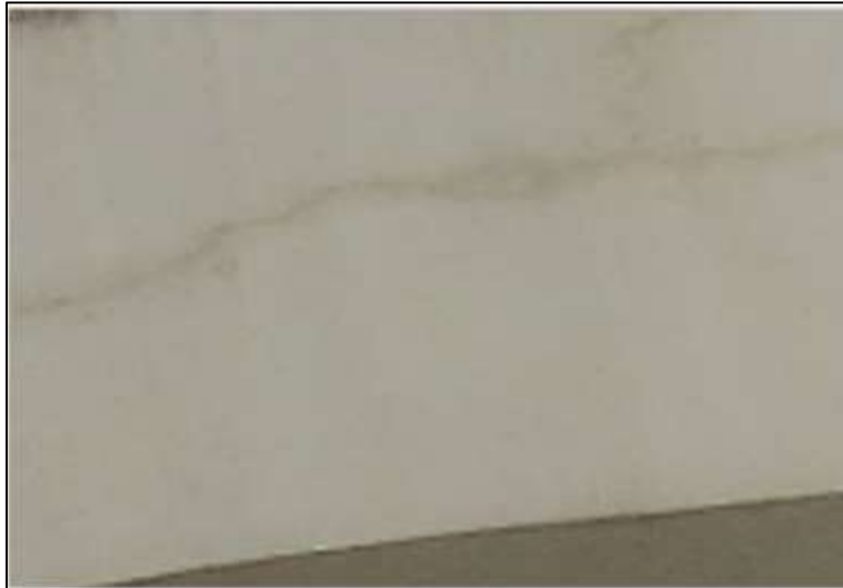
Figura 2.5 – Fissura horizontal em sacada revestida em argamassa. Fonte: Autor.
