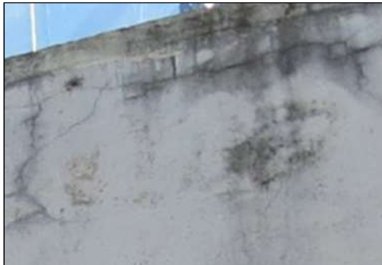
Figura 2.6 – Fissuras distribuídas em um sistema de revestimento em argamassa. Fonte: Autor.
