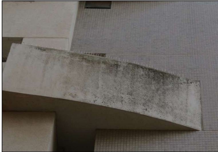
Figura 2.10 – Manchas de umidade em revestimento em argamassa. Fonte: Autor.
