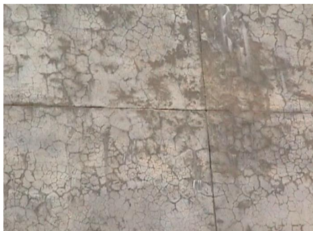
Figura 17: Fissuras geradas pela retração superficial em parede de concreto
