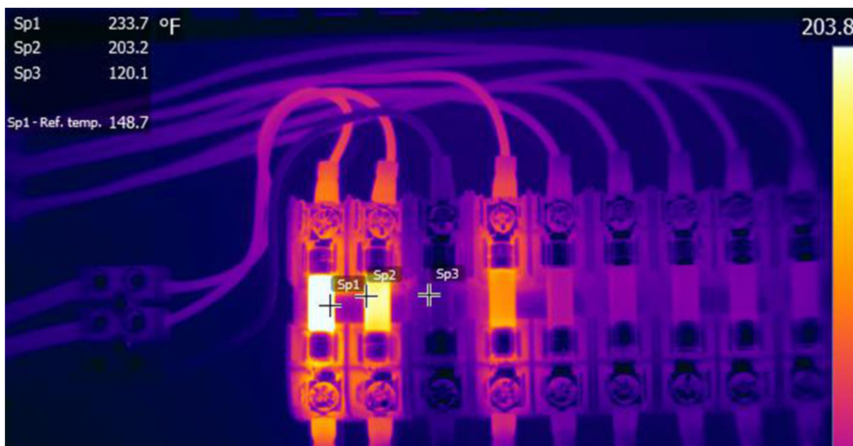
Figura 4 – Exemplo de análise de termografia de painéis elétricos utilizando câmera termográfica. Fonte: IFELL (2021).
