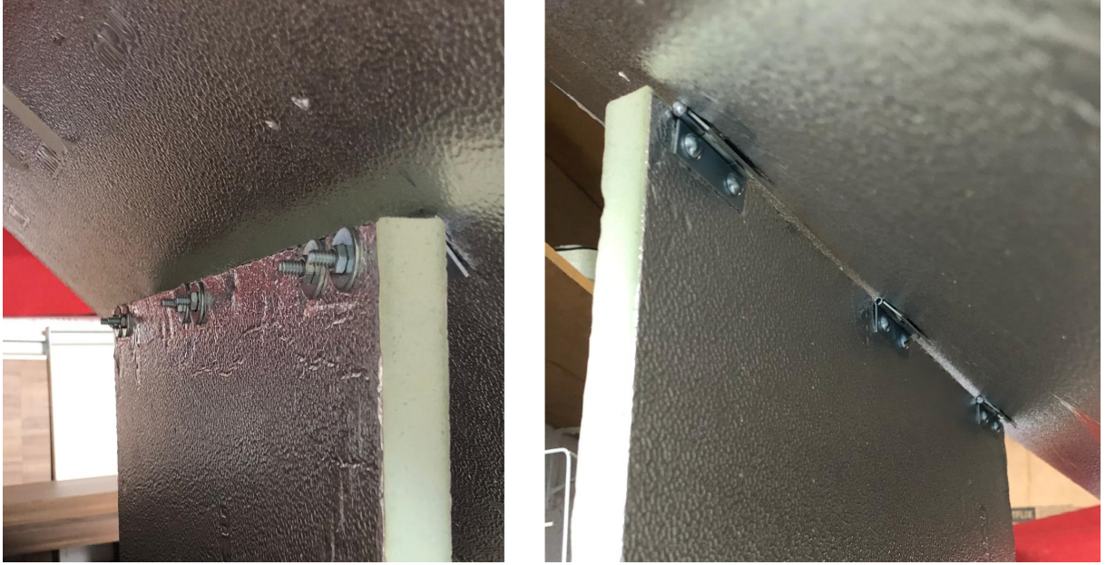
Figura 6.3 – Dobradiças do suporte da chaminé solar
