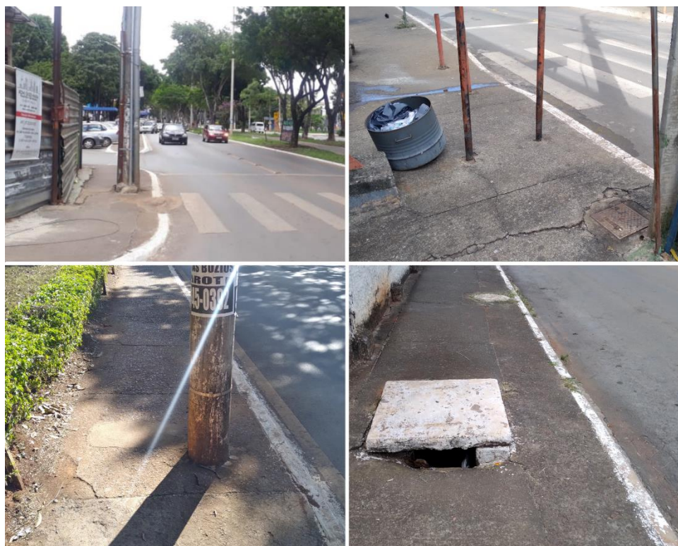
Figura 4-6. Postes de iluminação e outras obstruções que comprometem a largura dos segmentos. Fonte: Elaboração dos autores.
