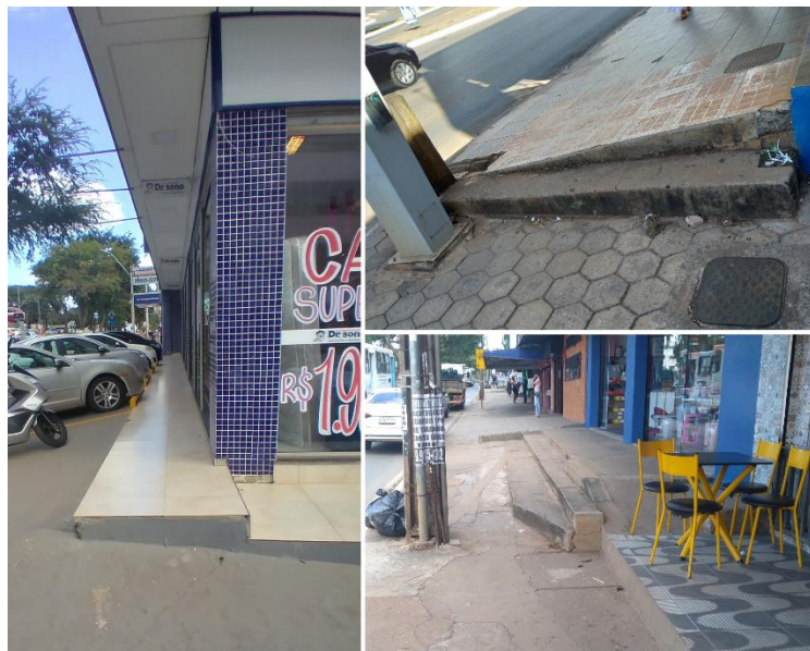
Figura 4-4. Desníveis nas calçadas adjacentes aos comércios. Fonte: Elaboração dos autores.
