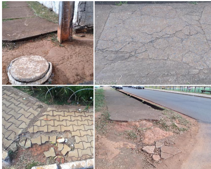
Figura 4-3. Pontos em que a pavimentação estava inadequada. Fonte: Elaboração dos autores.
