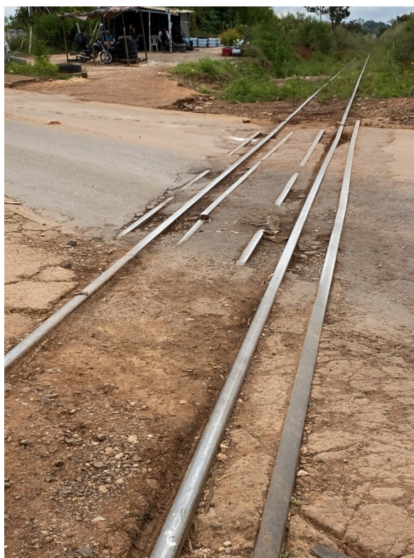
Figura 3.7 - Estado de Degradação da Ferrovia
