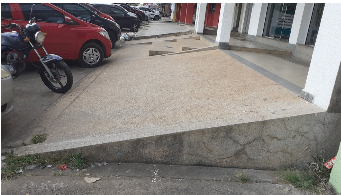
Figura 10 - Calçada da Avenida Comercial do Paranoá antes da reforma
