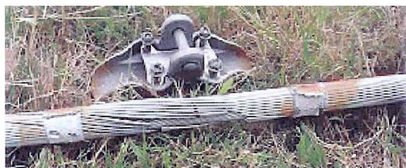
Figura 1.2 – Falha típica por fadiga em sela de fixação (SNEGOVSKI, 2004).
