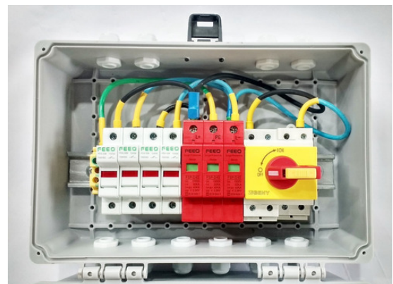
Figura 16 – Caixa de junção real, montada manualmente. (ML, 2021)
