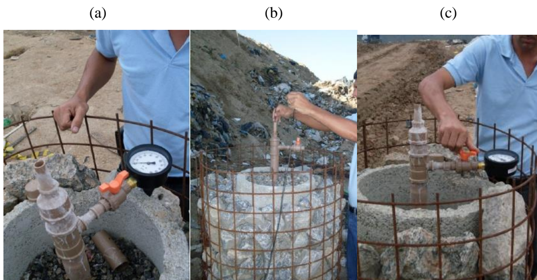
Figura 2.24 – Piezômetro do tipo sifão utilizado em aterros sanitários (Schuler, 2010): (a) vista superior; (b) leitura do nível piezométrico com torpedo; e (c) leitura da pressão de gás no manômetro.
