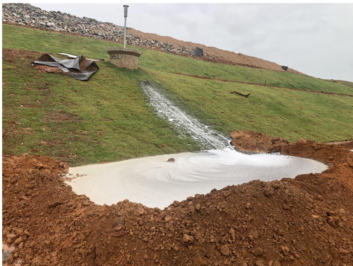
Figura 4.3 - Extravasamento de lixiviado pelo maciço do ASB (08/04/2019).
