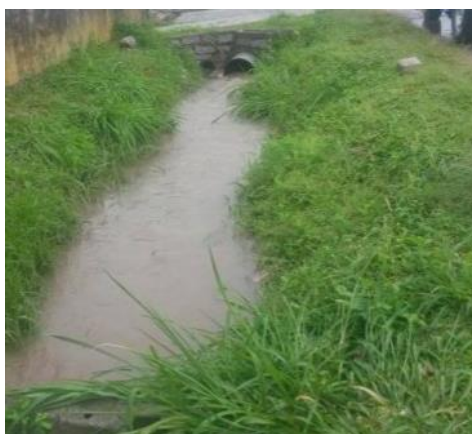
Figura 3-19 – Vala de infiltração alagada ( PACHECO, 2015 ).
