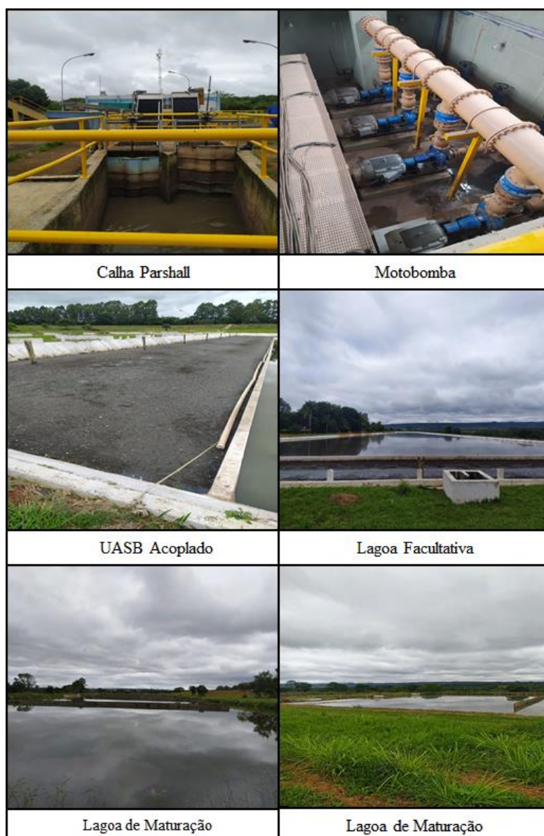
Figura 4.2 - Imagens dos sistemas operacionais da ETE Planaltina (Imagens obtidas em 09/02/2021)
