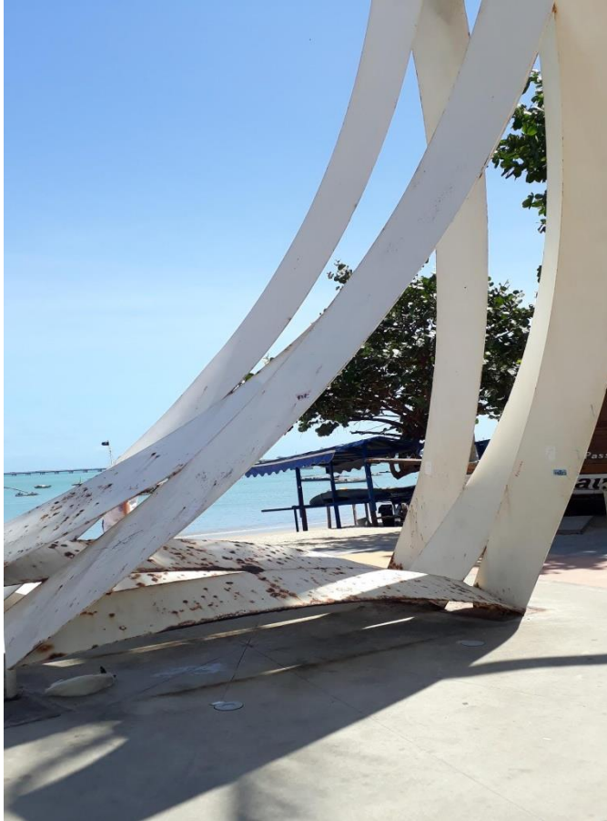
Figura 34: Monumento ao Jangadeiro, condições em dezembro de 2021.
