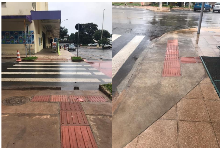
Figura 4.2 – Detalhes de piso tátil próximo a faixa de pedestre
