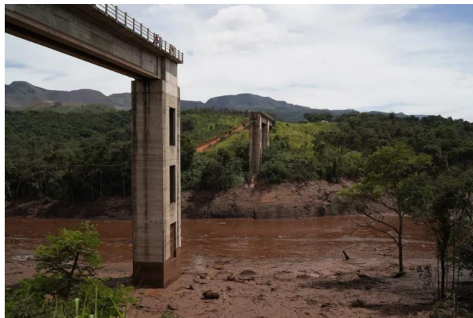
Figura 2.8 – Corrida de lama provocada pela ruptura da barragem em Brumadinho derrubou trecho de ponte ferroviária (CORREA, 2019).
