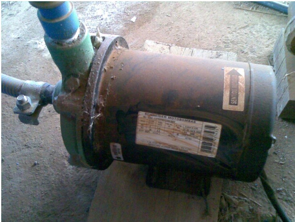
Figura 6. Detalhe do conjunto motobomba de 551,62 watts.
