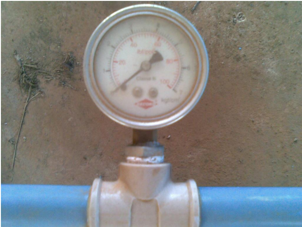
Figura 7. Detalhe do manômetro com faixa de pressão de 0 à 686,47 kPa.
