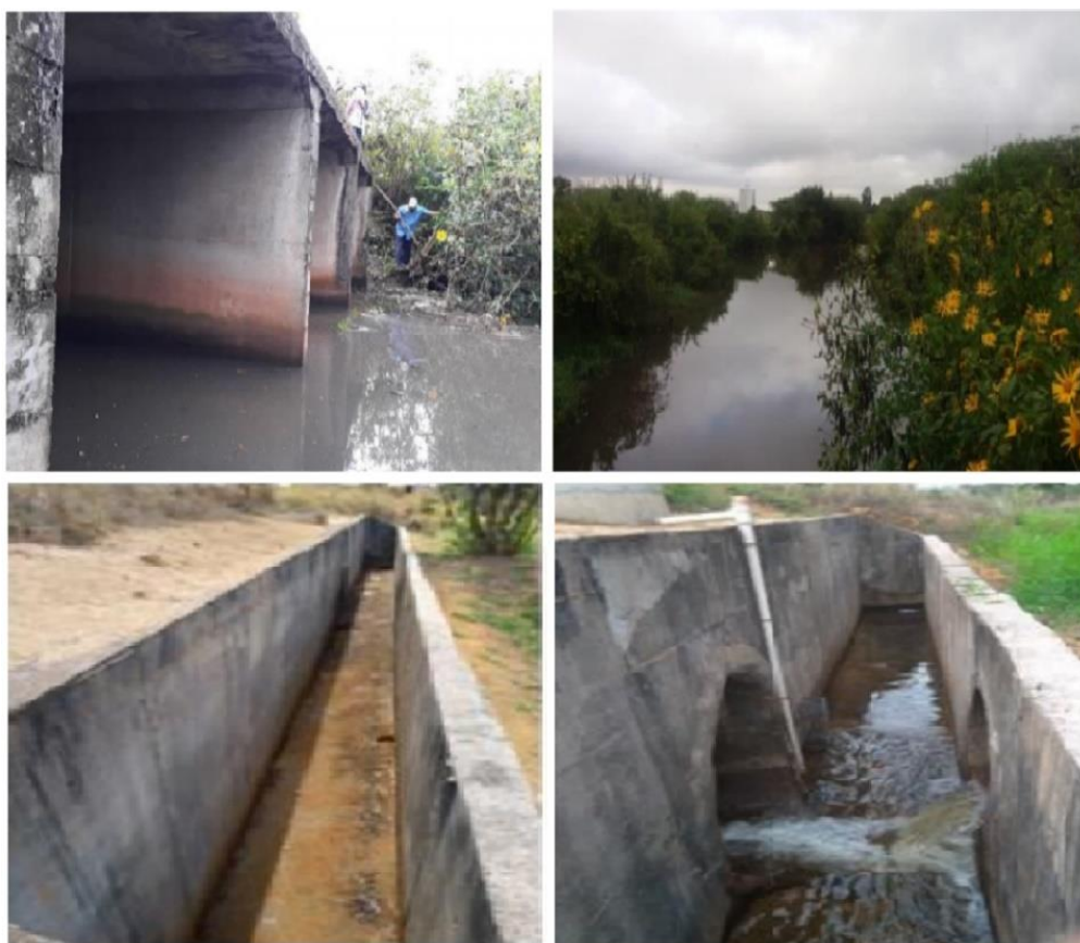
Figura 4. 7 – Fotos da galeria de entrada da lagoa; a área alagada imediatamente após; o vertedouro; descarga de fundo
