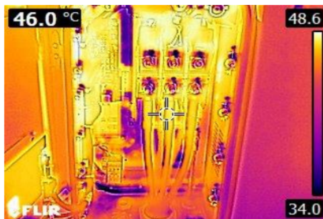
Figura 19 – Termografia da Saída CA
