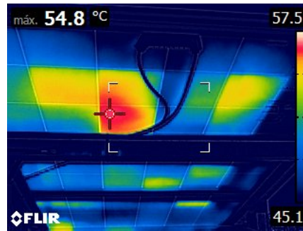
Figura 9 – Imagem da inspeção da parte de trás do módulo: FLIR modelo E6
