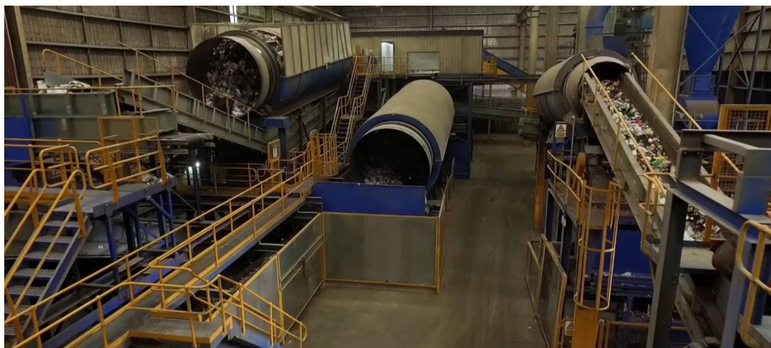
Figura 28. Foto interna da indústria de Materials Recovery Facility (MRF) Visy 93 .
