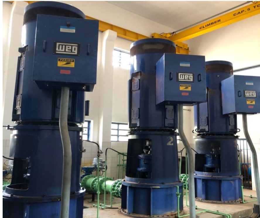
Figura 8 – Três conjuntos motor e bomba da unidade.
