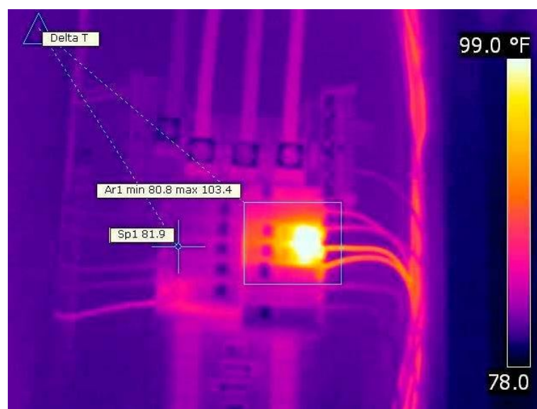
Figura 13 – Termograma de um quadro geral (ARTUR; RENILSON; AL, 2016).
