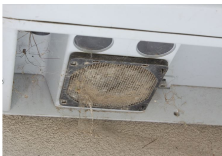
Figura 12 – Sujidades na entrada do cooler do inversor fotovoltaico. (TODESCHINI, 2017)
