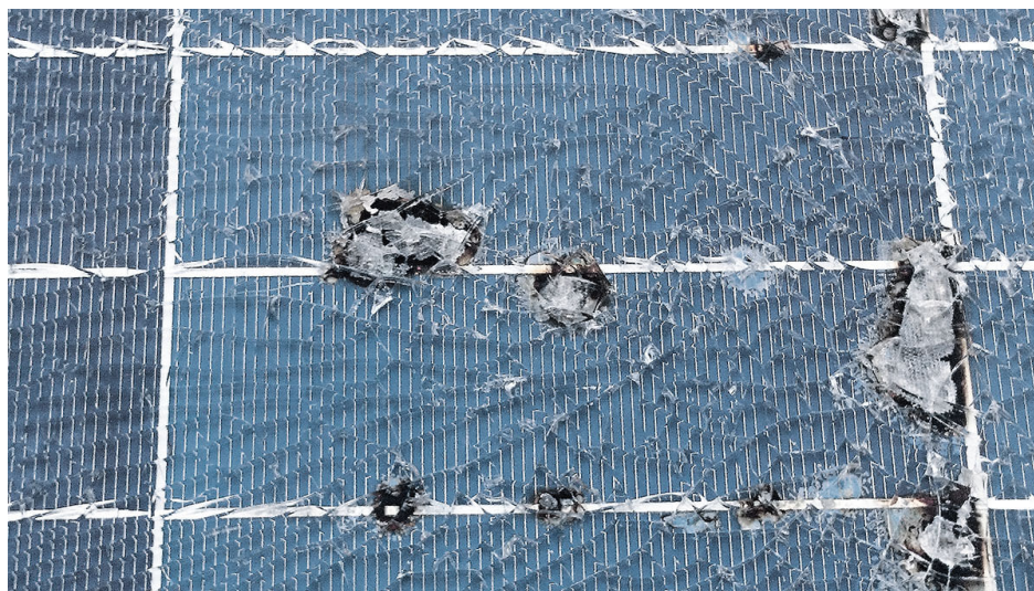
Figura 5.1: Destruição do painel fotovoltaico ao ser atingido por uma descarga atmosférica direta (19).
