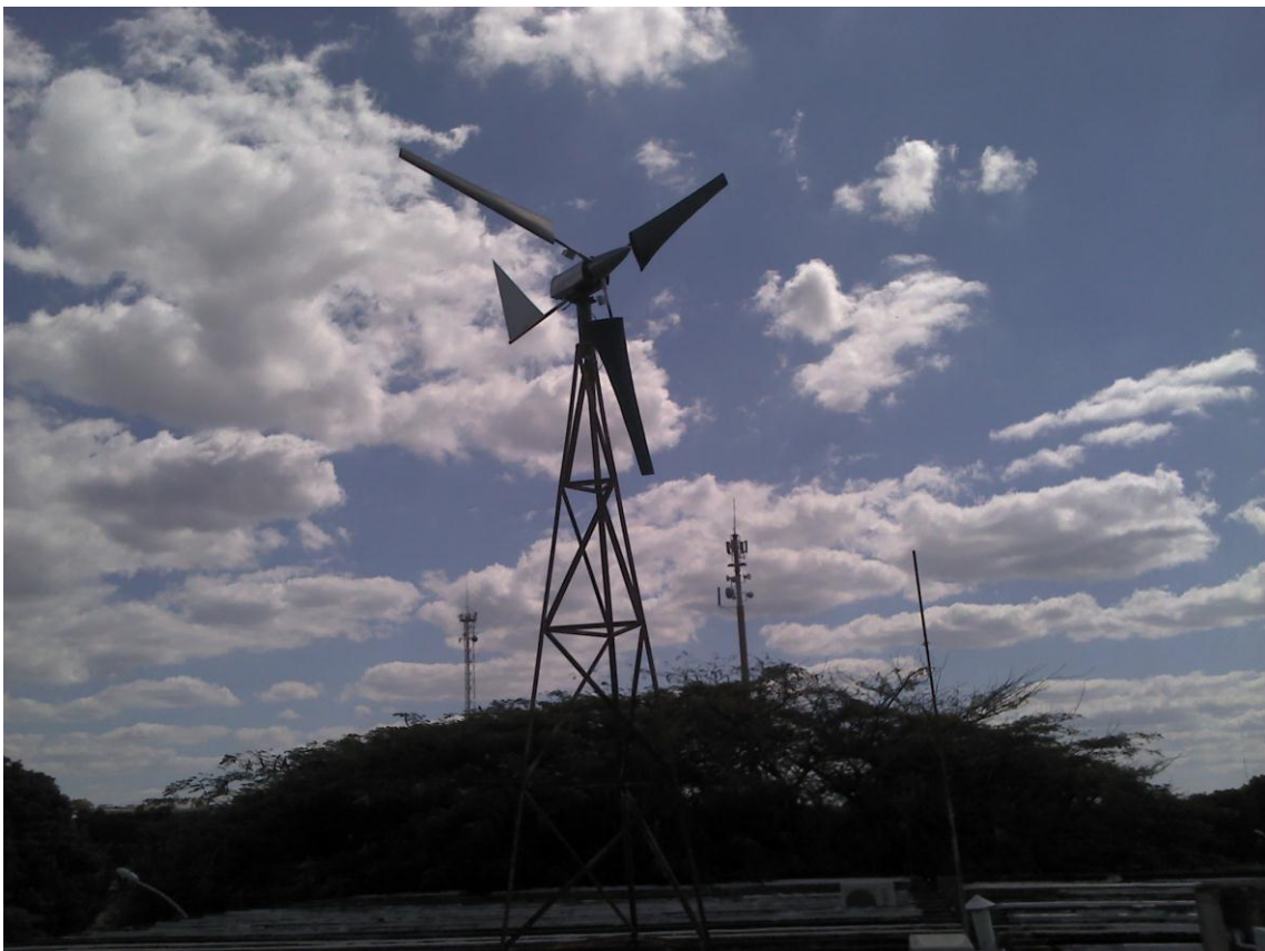
Figura 3.47 – Gerador eólico no prédio SG09
