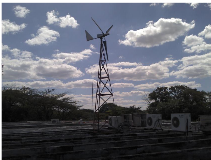
Figura 4.1 - Gerador montado na cobertura do SG9
