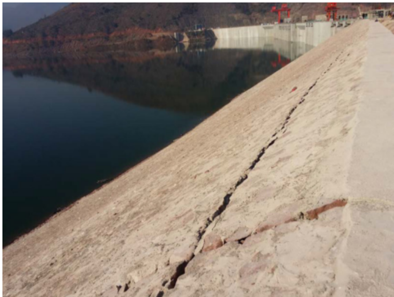
Figura 2.1: Exemplo de fissura em barragem (ZHOU; CHI; JIA, 2019)
