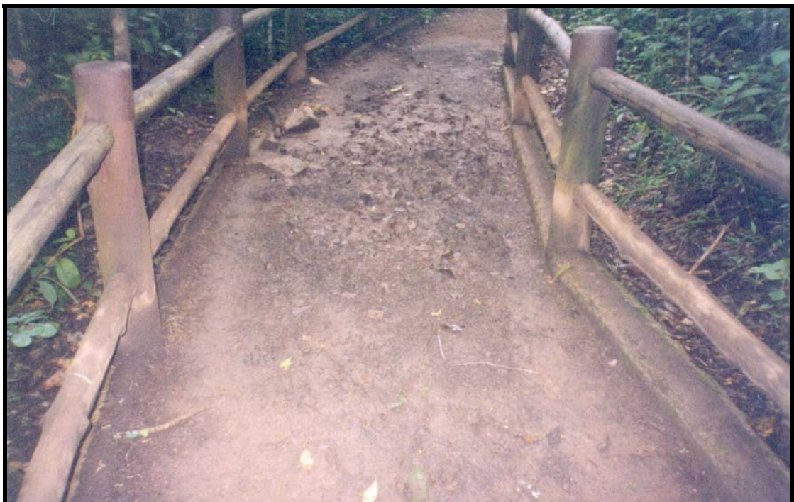
Trecho de lama, necessitando reparos
