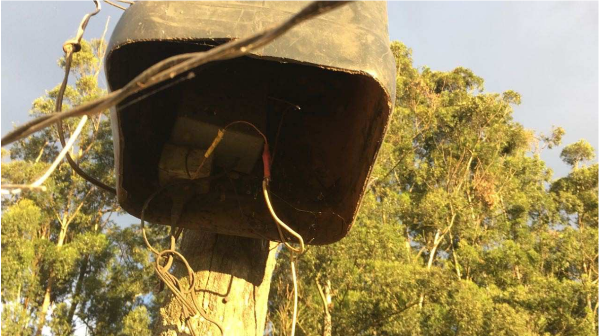
Figura 4.8 - Caixa contendo o eletrificador
