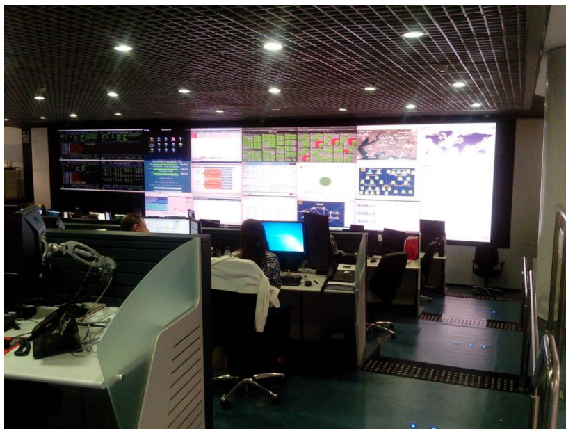
Figura 15 – Sala NOC do Data Center . Fonte: O autor
