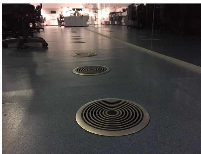
Figura 16 – Difusores de piso da sala NOC do Data Center . Fonte: O autor
