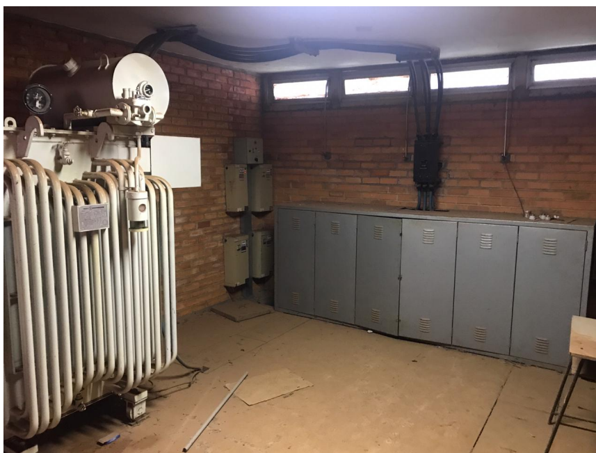
Figura 4.17: Sala do transformador e do qgbt
