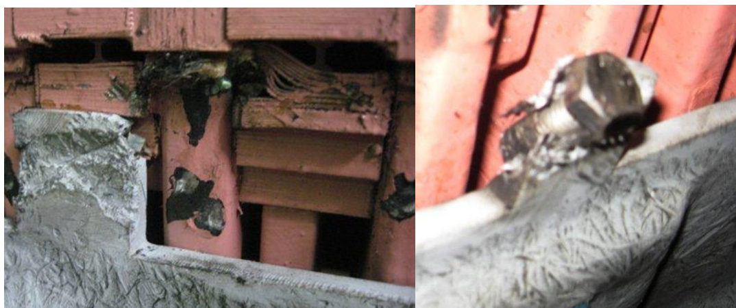
Figura 3.4 – (a) Danos causados pela presença do parafuso; (b) Parafuso alocado.
