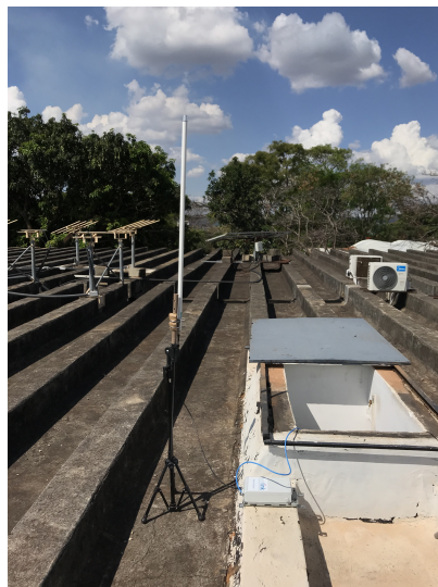
Figura 3.7: Antena e gateway sobre o prédio SG11.
