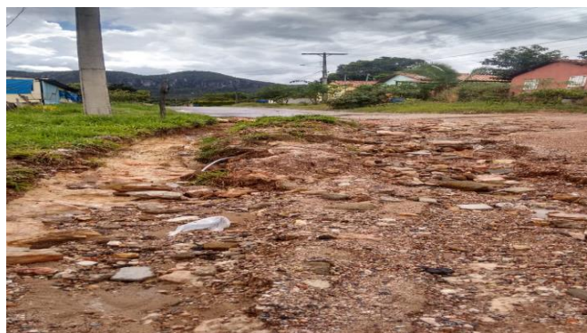
Figura 9- Rua sem pavimentação e com erosão e lama
