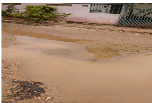
Figura 3- Calçamento no bairro Centro com acúmulo de água da chuva
