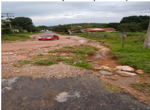
Figura 8- Rua com trecho parcial de pavimentação e esburacada
