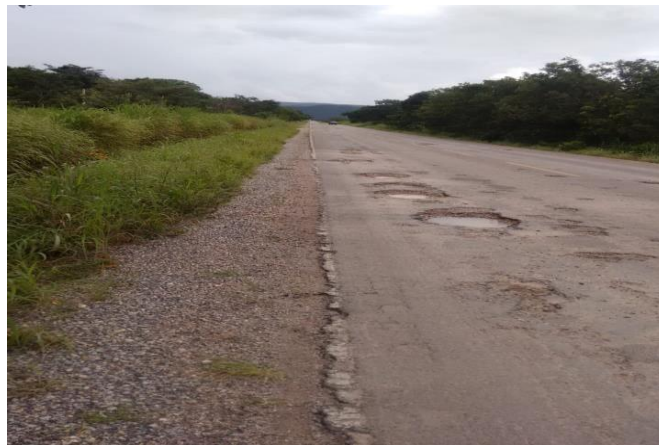
Figura 5- Rua asfaltada com degradação: buracos
