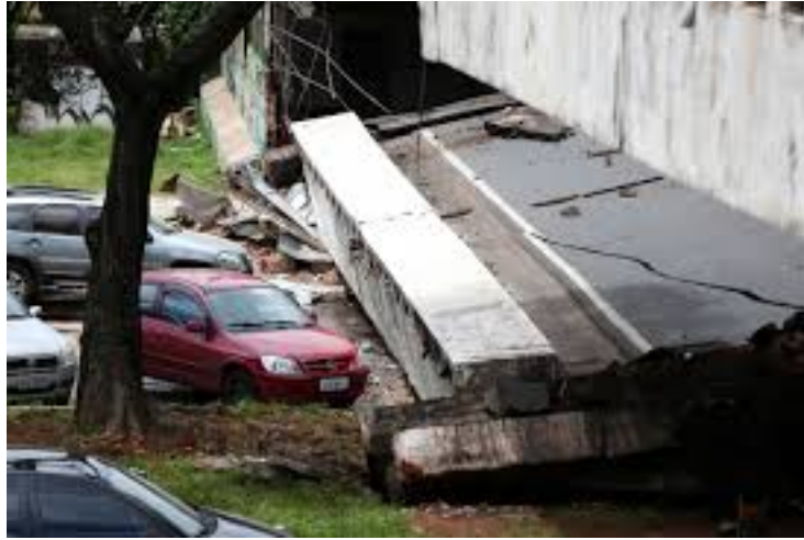
Figura 3 – Parte de viaduto que desabou na parte sul do Eixo Rodoviário de Brasília, ocorrido em 06 de fevereiro de 2018.
