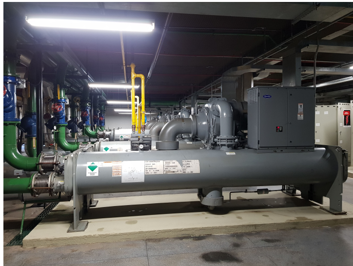
Figura 5.2: Chillers presentes no TST
