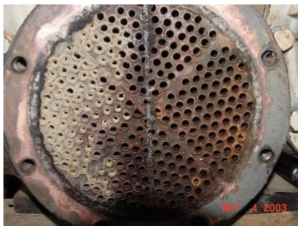
Figura 3.1: Comparativo entre tubos do condensador limpos e sujos (SERVICES, 2019)
