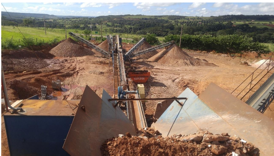
Figura 4.3 - Vista geral da Usina de Reciclagem
