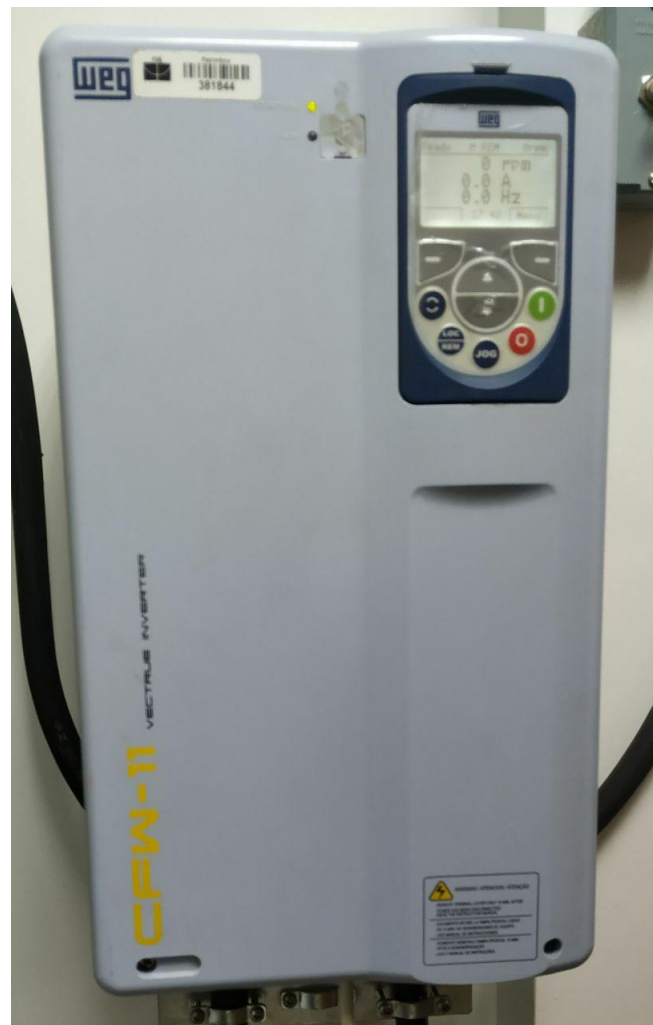
Figura 3.5: Inversor de frequência ligado e pronto para execução.
