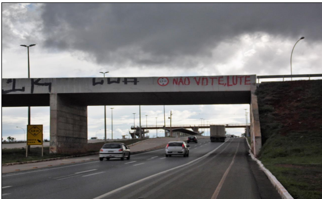
Figura 03: Rodovia de acesso à Região Administrativa do Gama-DF. Pichação e depredação de estruturas públicas.
