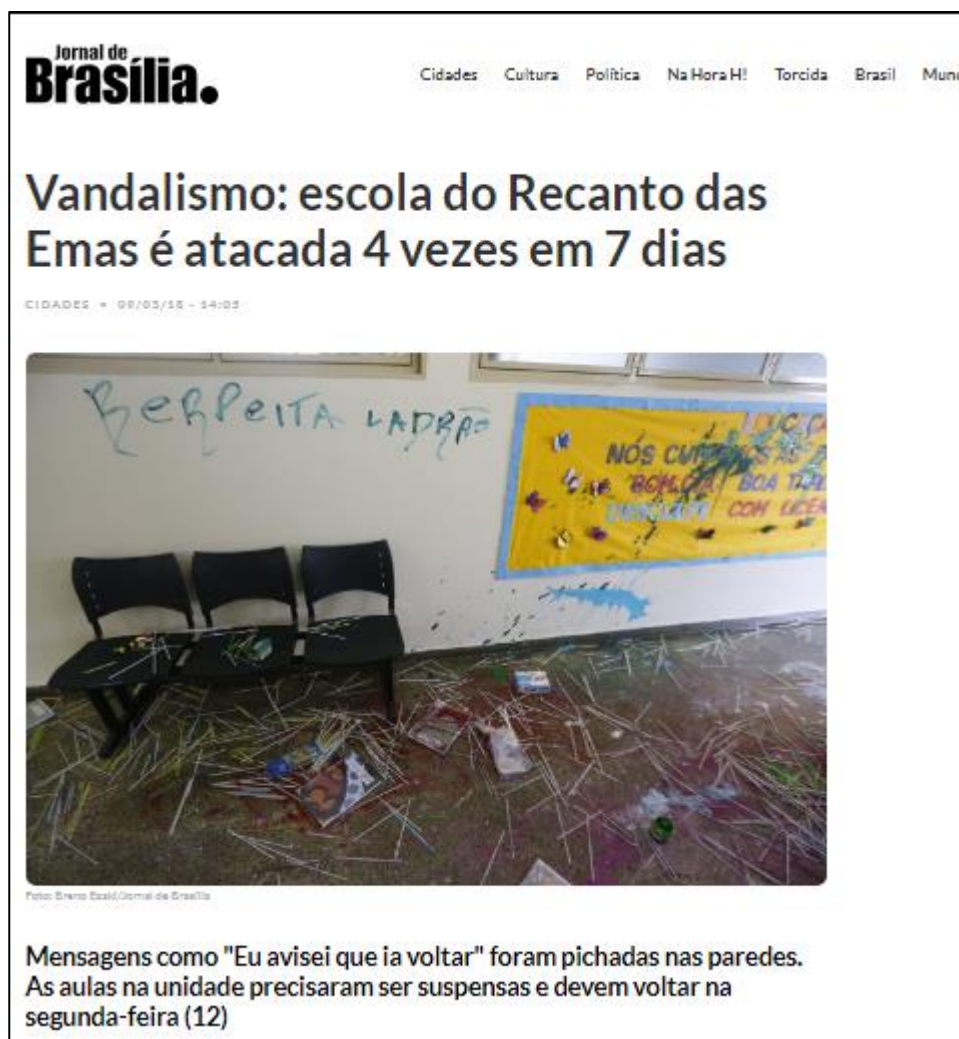
Figura 10: Escola depredada em Recanto das Emas- DF.
