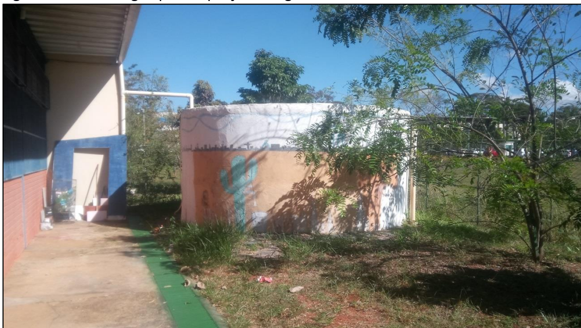
Figura 36. Caixa d'água para captação da água da chuva.
