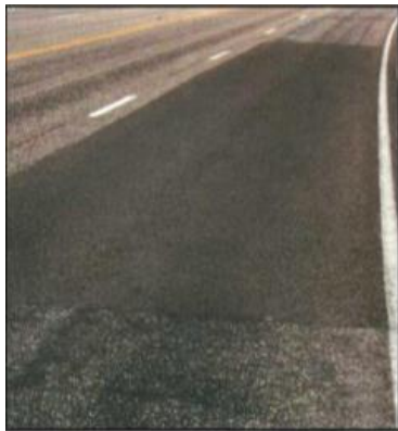
Figura 3.4 - Remendo (severidade baixa)
