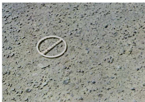
Figura 3.8 - Desgaste do pavimento. Fonte: (DAER, 1978)
