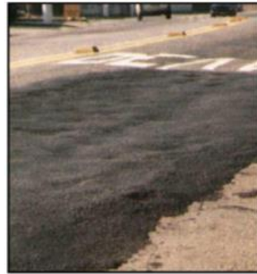
Figura 3.5 - Remendo (Severidade alta)
