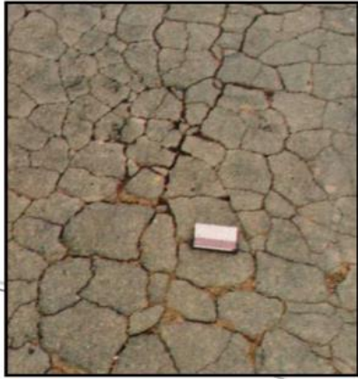
Figura 3.2 - Trincas por Fadiga (severidade alta)
