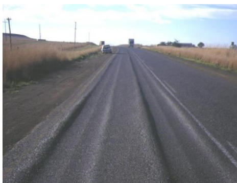
Figura 3.7 - Afundamento por fluência do revestimento asfáltico. Fonte: (BERNUCCI)
