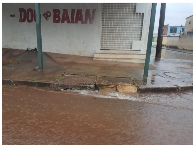
Figura 4-11: Sistema de captação de águas pluviais obstruído próximo à CL 316/416, na primeira rua paralela abaixo da Avenida Santa Maria.
