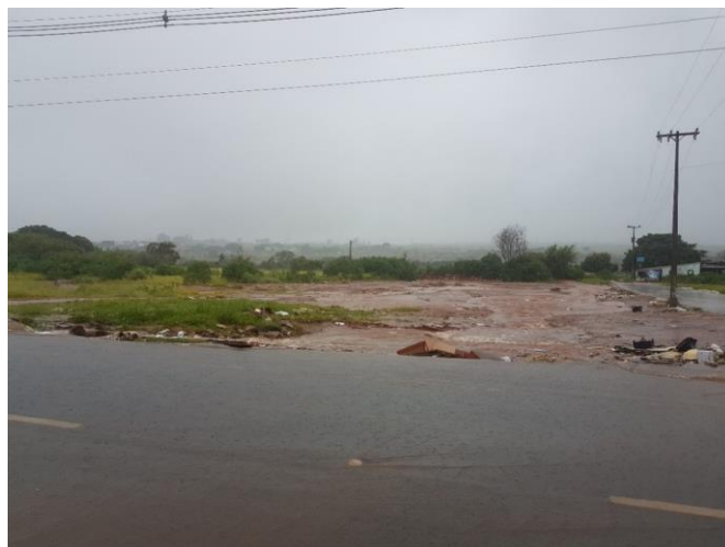
Figura 4-8: Grande região apresentando falhas na condução das águas pluviais, próxima à quadra CL 313/413, na Avenida Santa Maria.
