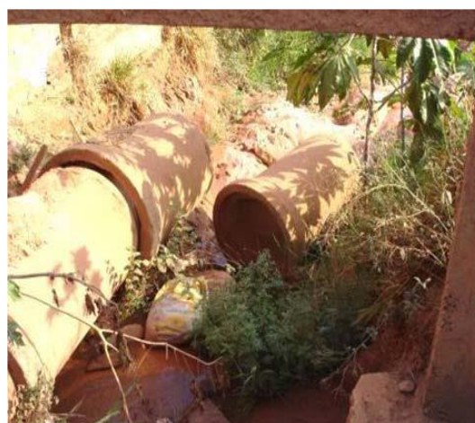
Figura 4.3 - Tubulações Provisórias para Escoamento de Drenagem Pluvial na Vila São José com Problemas Erosivos (perda da tubulação) (Topocart, 2010)
