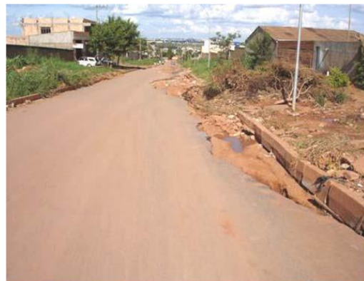
Figura 3.10 - Processos Erosivos em Vias Pavimentadas no Vicente Pires - ausência de sistema de drenagem pluvial (Topocart, 2010).
