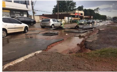
Figura 3.8 - Asfalto danificado devido a enchentes (G1 2 ).
