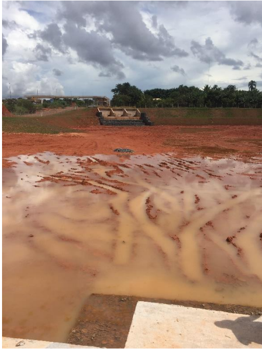
Figura 4.13 - Acúmulo de água na bacia de qualidade.
