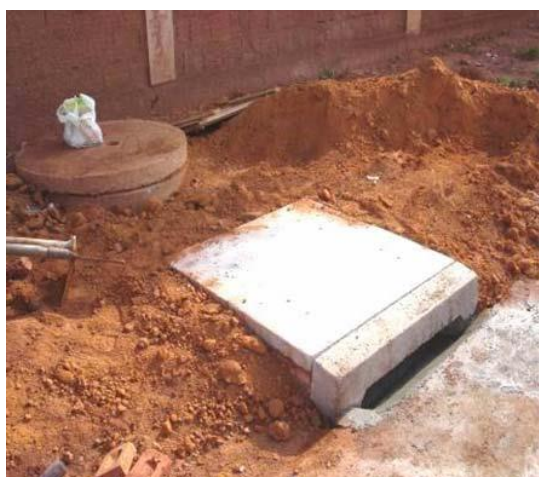
Figura 4.2 - Sistema Provisório de Drenagem Pluvial para Evitar Alagamentos na Vila São José (sistema sem critérios técnicos e fora do padrão da NOVACAP) (Topocart, 2010).
