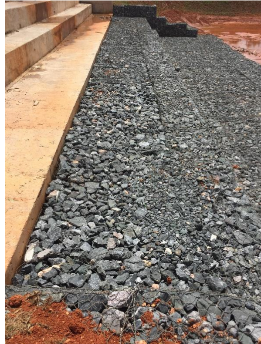
Figura 4.14 - Defeitos no gabião da bacia de detenção.
