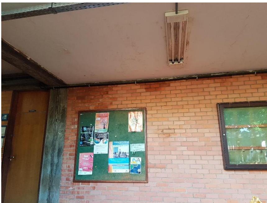
Figura 36 - Visão ampla das situações de infiltração – área 3
