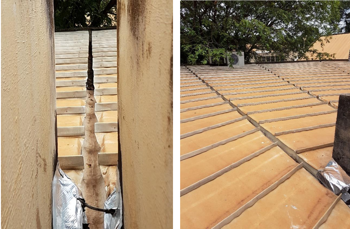
Figura 63 - Fotografias telhas 3 e 4; próximo a área de foco 5
