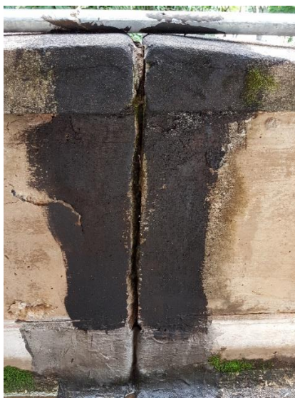
Figura 81 - Junta da platibanda sem impermeabilização e selagem
