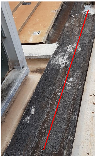
Figura 68 - Junta estrutural sem selante; em destaque
