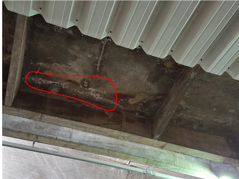
Figura 52 - Manchas de umidade e de eflorescências 2; eflorescências em destaque
