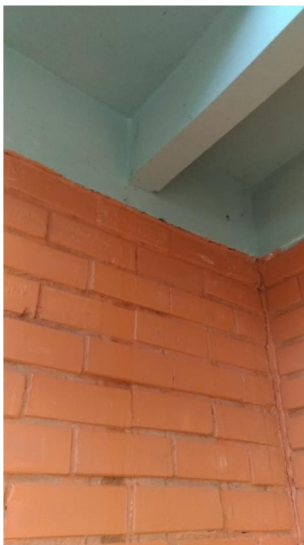
Figura 42 - Escorrimento de água na interface viga-alvenaria
