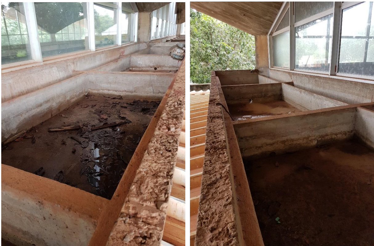
Figura 86 - Fotografias reservatórios de nível constante 1 e 2
