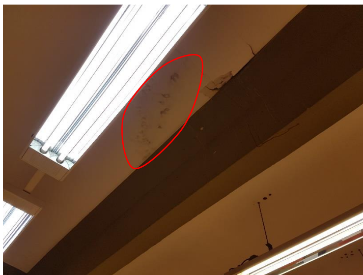
Figura 46 - Manchas de umidade no teto em destaque
