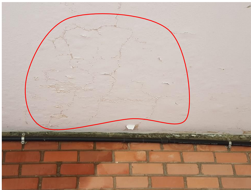
Figura 32 - Área de goteira adjacente ao escoamento – área 2; área em destaque
