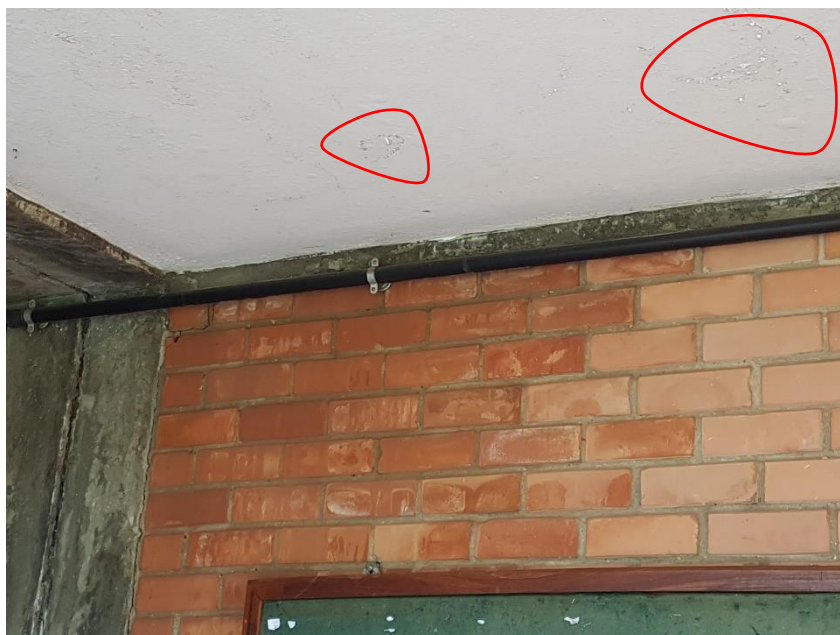
Figura 35 - Goteiras e indícios de escoamento de água – área 3; goteiras em destaque
