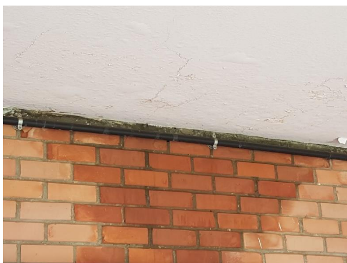
Figura 30 - Goteiras múltiplas e escorrimento de água na alvenaria – área 2
