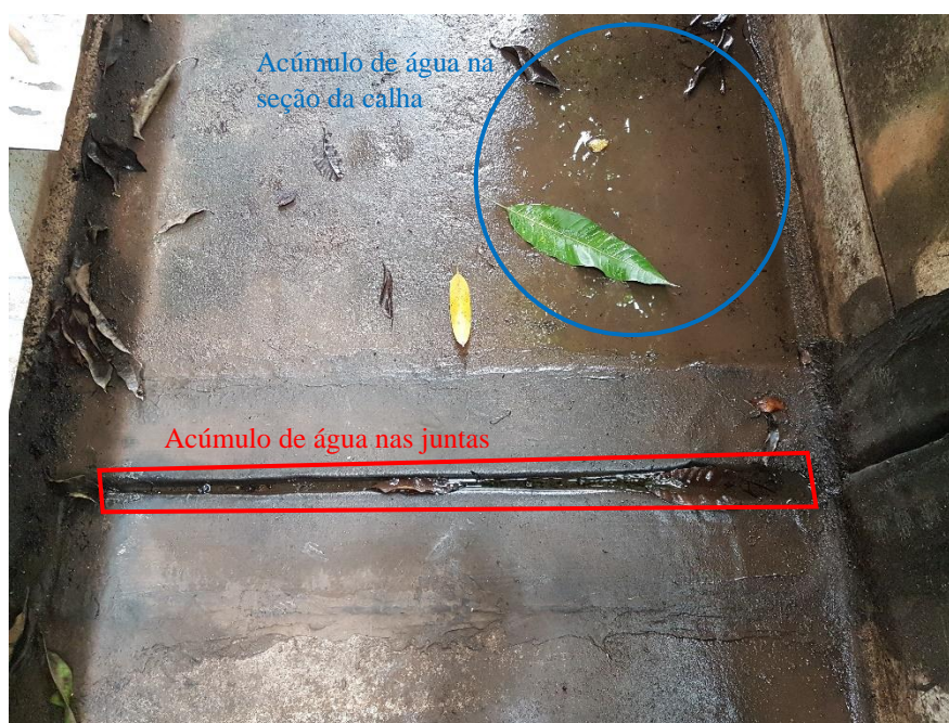
Figura 83 - Acúmulo de água na junta e na seção da calha
