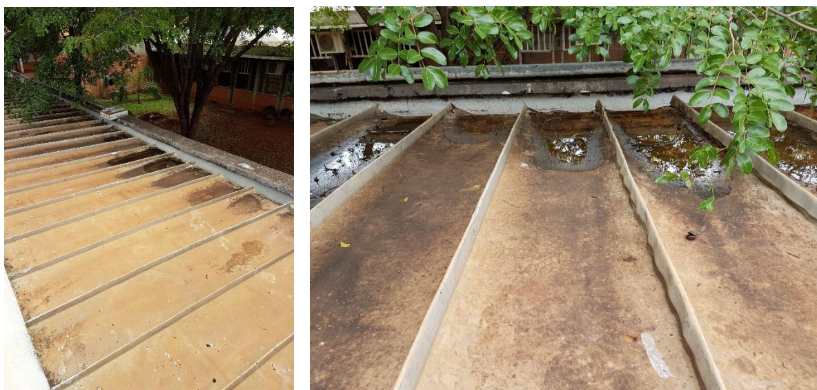
Figura 62 - Fotografias telhas 1 e 2; próximo a área de foco 1
