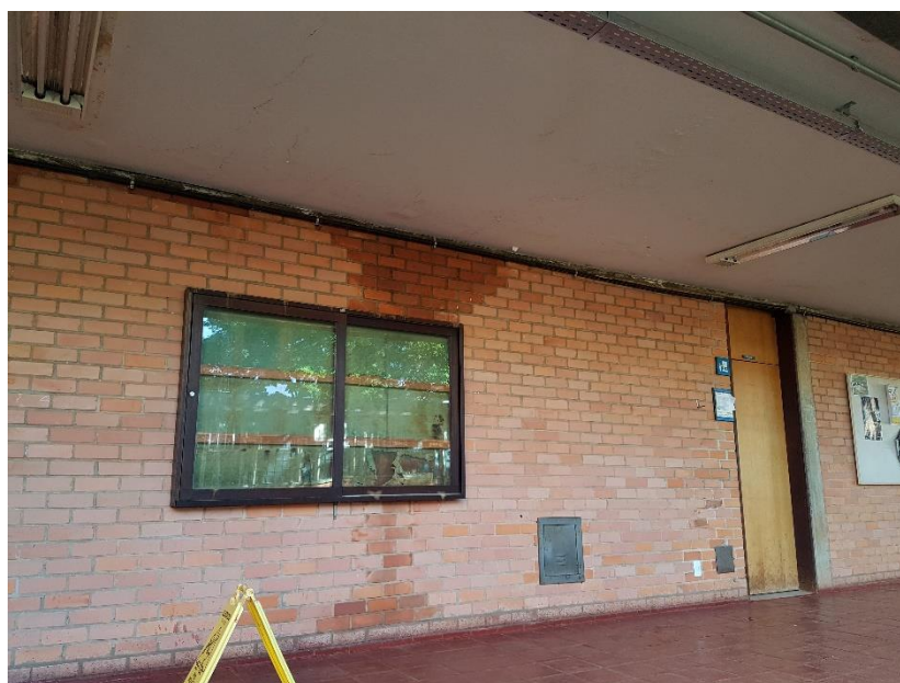
Figura 33 - Visão ampla do local com infiltrações – área 2
