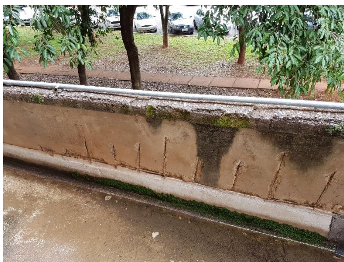
Figura 79 - Armaduras aparentes da platibanda
