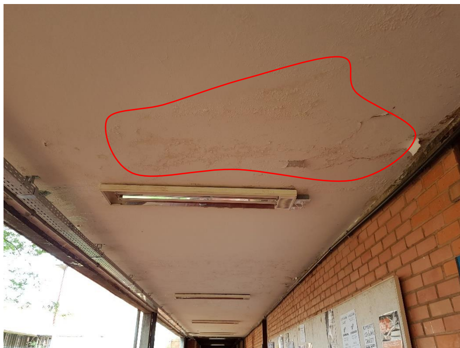
Figura 37 - Goteiras na área 1, em data diversa; goteiras em destaque
